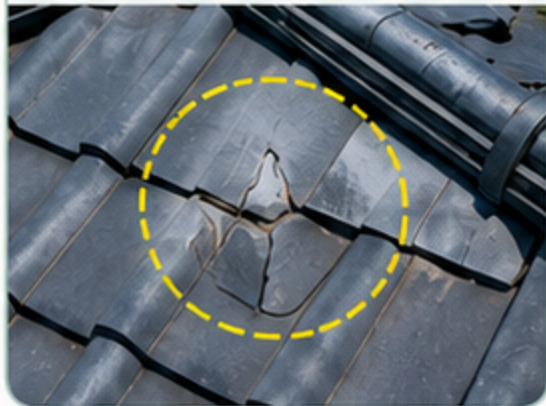
破損箇所のズーム画像
